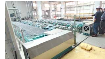
구미 그룹통합폐수처리시설 수요처 : 코오롱인더스트리(주) 용 량 : 10,000m 3 /day
