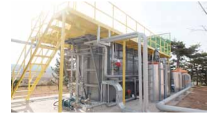
무안청계 3차처리시설 수요처 : 무안군 용 량 : 1,600m 3 /day
