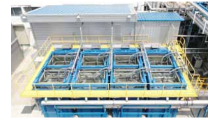
코오롱글로벌 폐수처리시설 수요처 : 코오롱글로벌(주) 용 량 : 3,300m 3 /day
