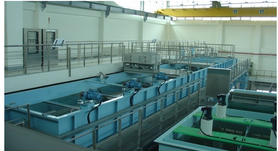
대전 수자원공사 막여과 실증플랜트
